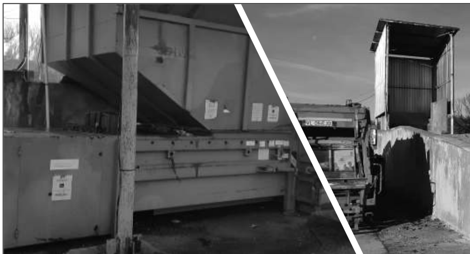
Figura 4-5: Echipamente tehnologice stație de transfer Fârtățești
