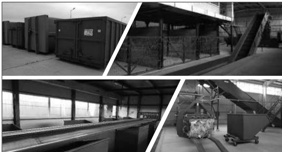
Figura 4-16: Dotări stație de sortare Râureni
